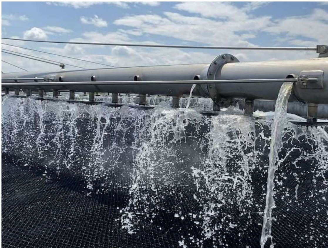
Planta de Tratamiento de Aguas
