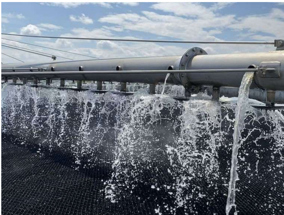
Planta de Tratamiento de Aguas
